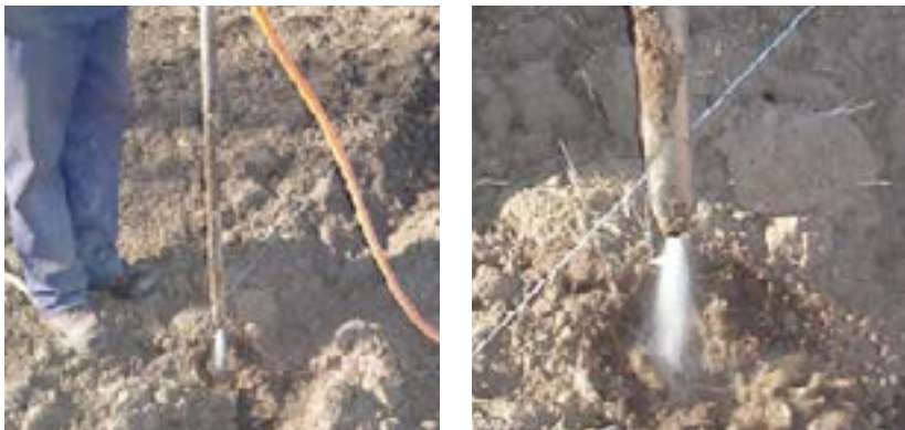
Figura 19. Detalle de la barreta hidráulica en funcionamiento (Fotos extraídas de Cancio y Thomas 2011).
