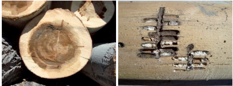
Figura 59. Daños de tala-drillo en la madera: manchado (izquierda) y galerías en la madera (derecha) (fotos R. Villaverde)
